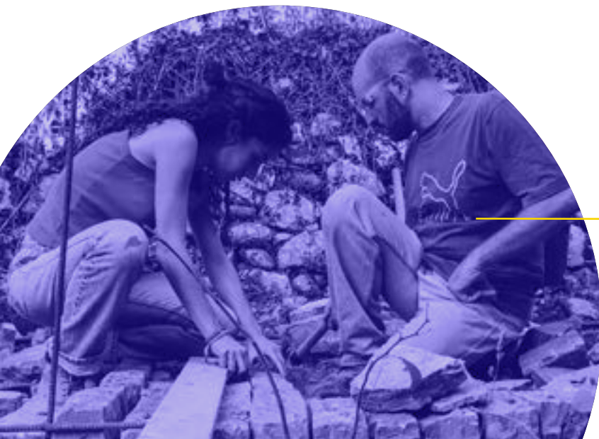
Deux participant-e-s lors d'un atelier pratique sur les techniques de construction traditionnelles « KalderimiX2 » (Crédit photo : Athena Apostolou | Blk © 2019)
